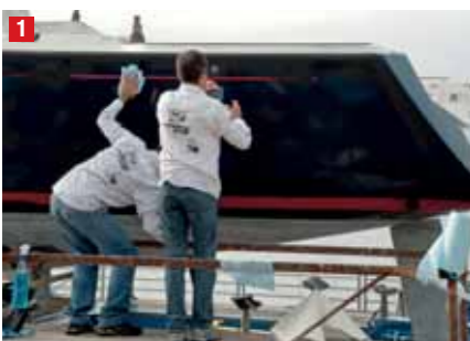
1 La preparazione è semplice, basta pulire la superficie ed eliminare le imperfezioni con stuccature.
